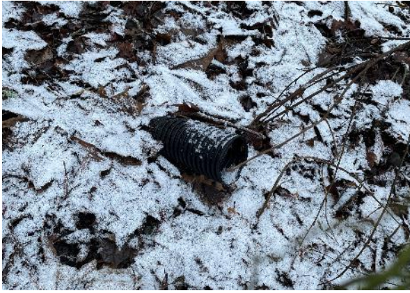
Figur 6. Lågpunkten i nordväst dräneras med smalt rör.
