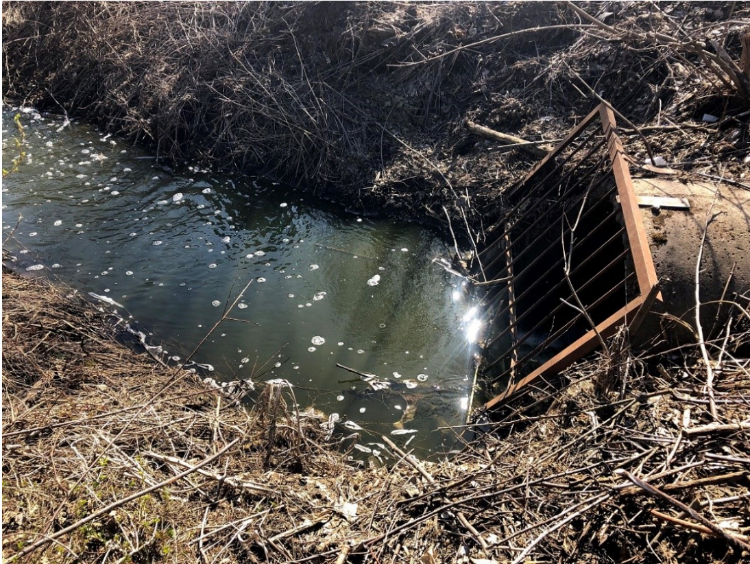
Figur 17. Dagvattenledning nordväst om planområdet vid väg 53 och Trumptorp-Hällberga vsf som tar emot dagvatten från planområdet. Foto: WRS (2021-04-19).
