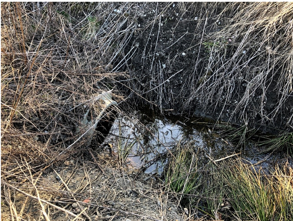
Figur 14. Trumma på östra sidan under Fasanvägen där mycket sediment ansamlats. Foto: WRS (2021-04-19).
