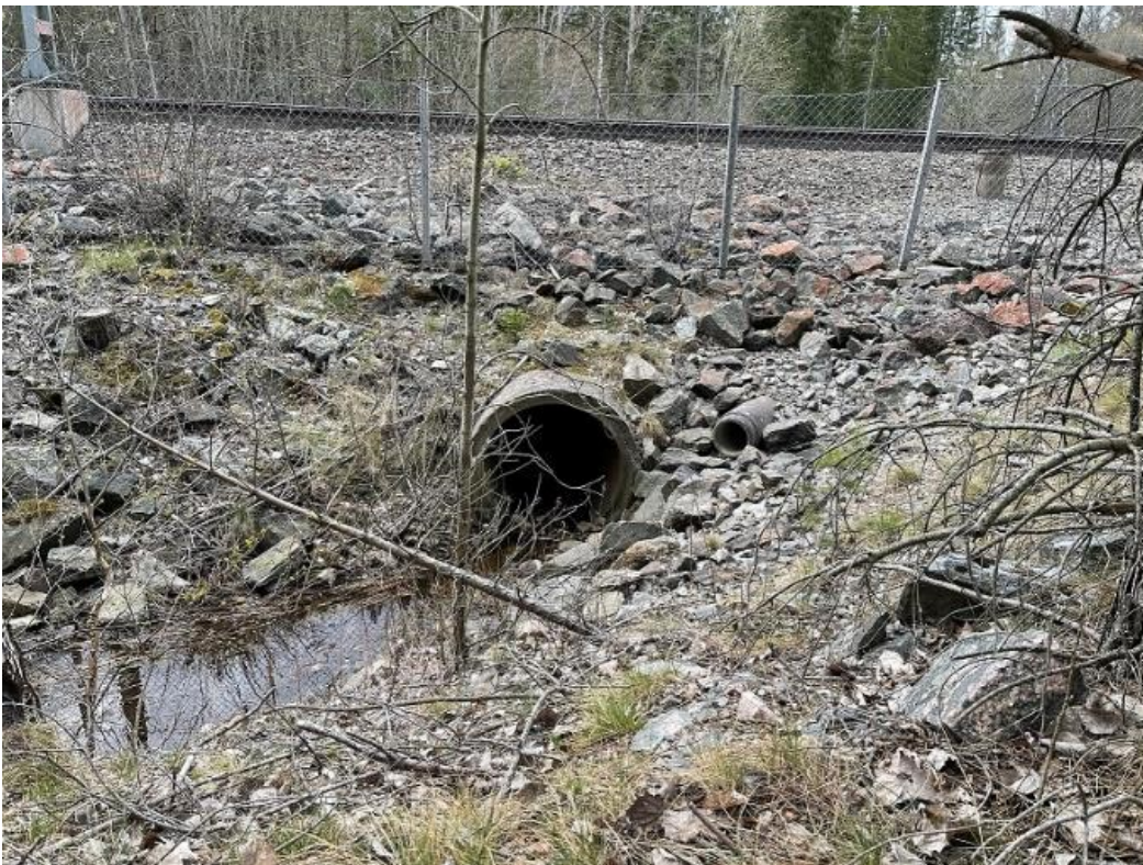
Figur 16. Trumma (100 cm diameter) under järnvägen som tar emot vatten från stora dike. Foto: WRS (2021-04-28).
