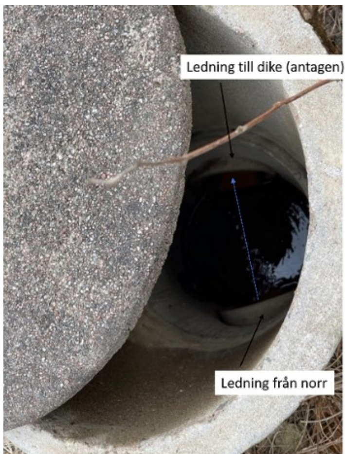
Figur 11. Dagvattenbrunn 1 (se Figur 10) inom planområdet. Inlopp från norr och vidare avledning söderut mot diket. Foto: WRS (2021-04-19).
