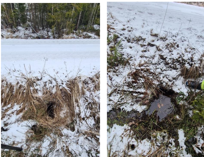
Figur 5. Inlopp (t.v) respektive utlopp (t.h) av trumma vid våtmark 2 under Fasanvägen. Trumman utgör utloppet från våtmarken.
