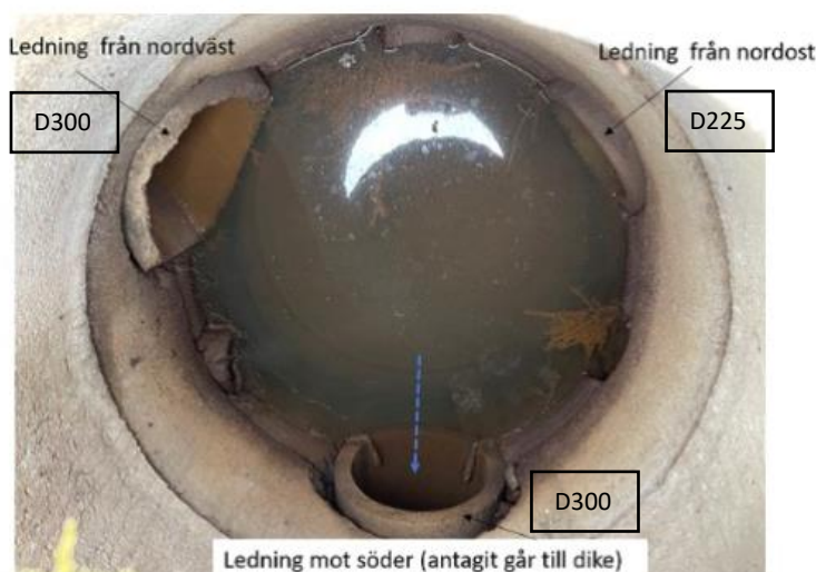
Figur 7. Öppnad dagvattenbrunn inom detaljplaneområdet för Odlarvallen 5. Utgående ledning är en D300 BTG. Foto från WRS utredning (2021).
