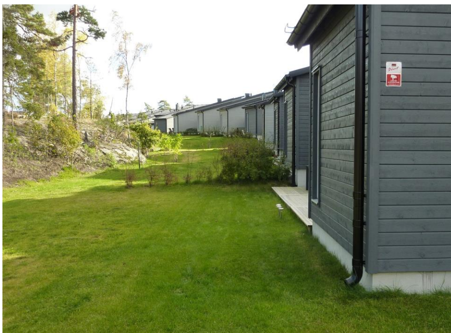
Figur 13. Notera att marken sluttar bort från huset. Där gräsmattan möter den högre terrängen finns ett lågområde/svackdike som kan avleda stora vattenmängder vid extrem nederbörd och där vattnet även tillåts "stå" och infiltrera under längre tid.
