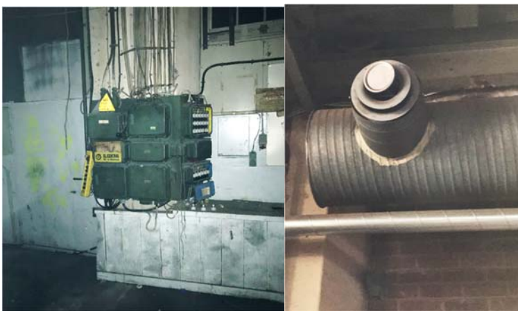
Figur 3.4 Tv elcentral i närheten av prov 9 på entreplan och th visar ventilationskanal med kitt som ej provtagits på entreplan, dock på plan 1 utan att asbest påvisats.
