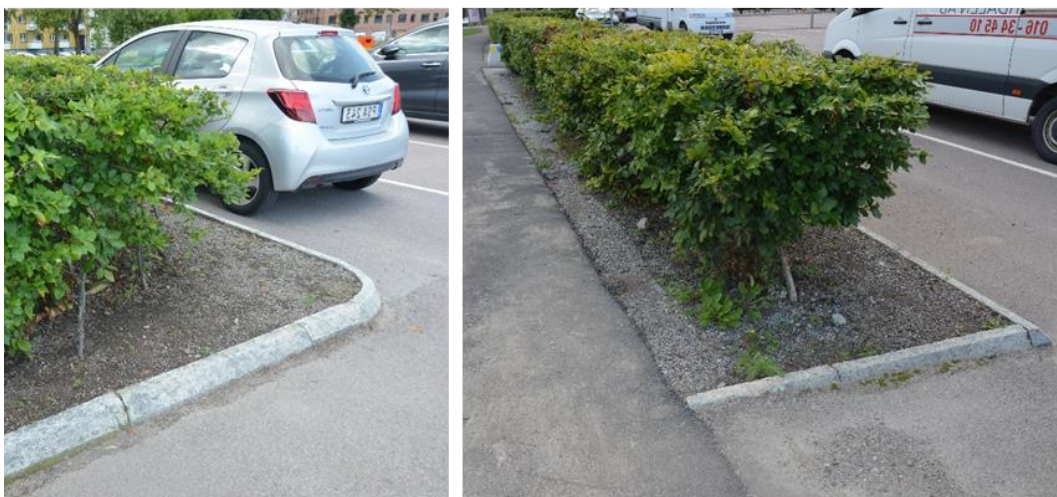
Figur 16. Exempel på befintliga upphöjningar, kantstenar och olämpliga placeringar av dagvattenbrunnar som förhindrar infiltration inom planområdet. Övre bilden: om metallkanten tas bort och grönytan sänks kan dagvatten rinna till grönytan istället för direkt ner i dagvattenbrunnen. Nedre vänstra bilden: genom att ta bort kantstenarna och sänka grönytan kan dagvattenfördröjning möjliggöras. Nedre högra bilden: tillrinning är möjligt från höger, men eftersom omkringliggande område ej lutar mot buskarna och växtmaterialet ej är nedsänkt skapas ingen fördröjningskapacitet.
